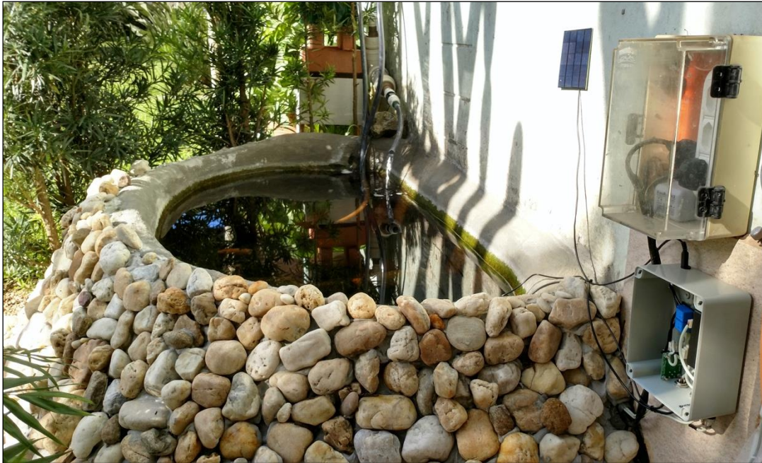
Figura 21 –Fishming instalado com todos os sensores conectados
