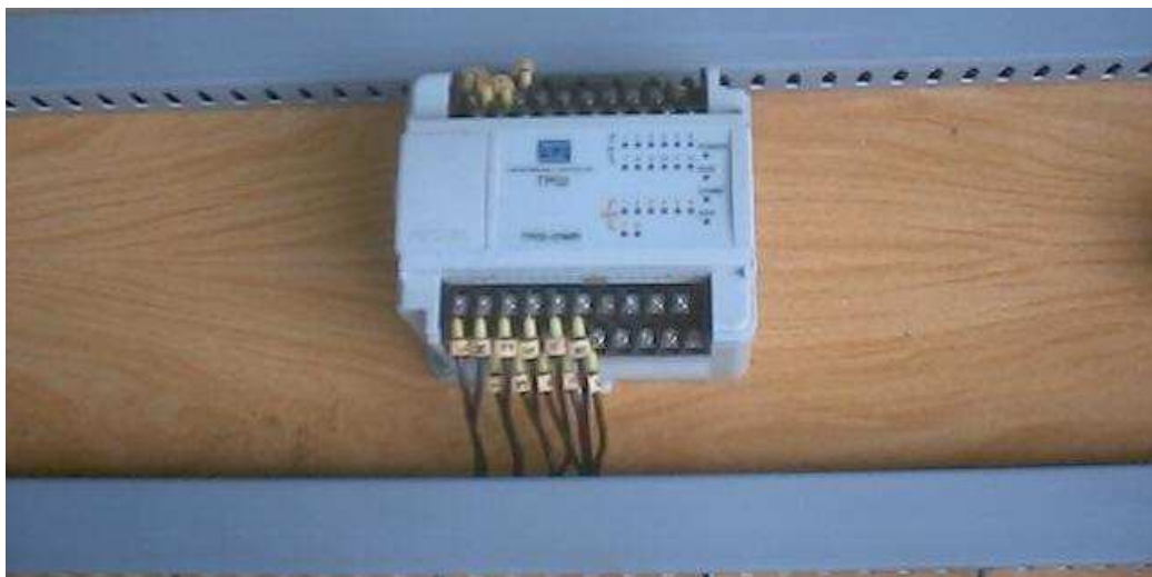
Figura 30 - Foto do CLP e das conexões de saída
